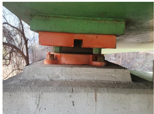
P1 받침 부식 임시조치(재도장) 전 현황
